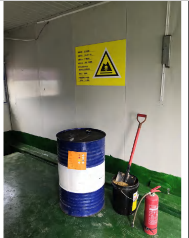
危废间危废放置情况
