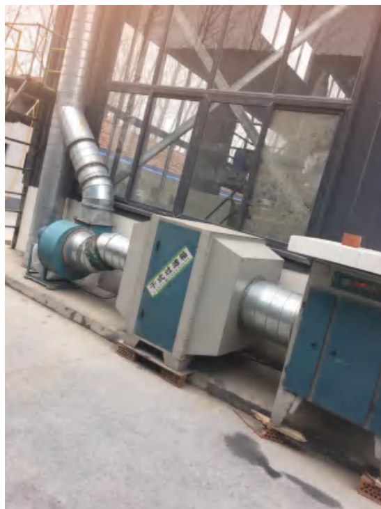
废气处理设施
